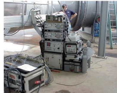
Assistenza tecnica, start-up e test run
